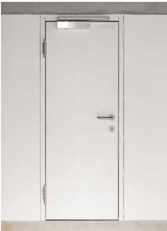
PRIODOOR FSA Feuerschutzabschlüsse kamen in einheitlicher Optik in den Technikräumen zum Einsatz.
