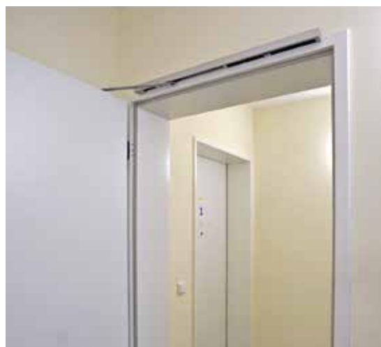
BRANDSCHUTZTÜREN FW 90 mit automatischem Schließsystem trennen die Wohnungen und Schleusen vom jeweiligen Treppenhaus.
