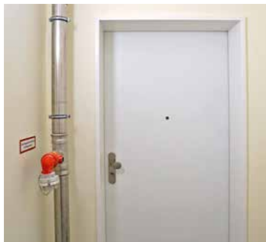
SCHLEUSE gesichert mit Löschanlage
