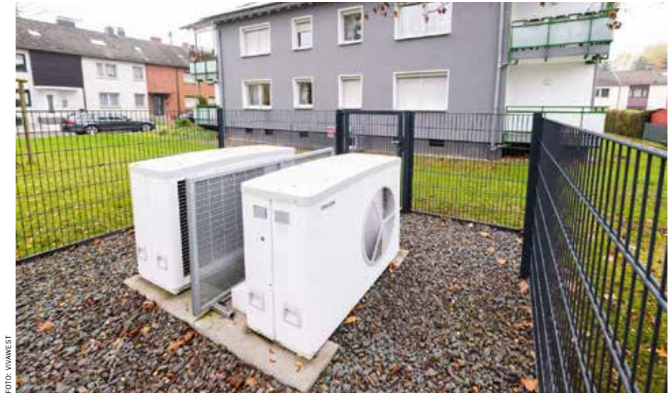
Im Quartier Suderwich wurden 28 Wärmepumpen paarweise auf Grünflächen platziert, um 14 Gebäude zu heizen. Die kleine Kaskade erzeugt weniger Schallemissionen.
